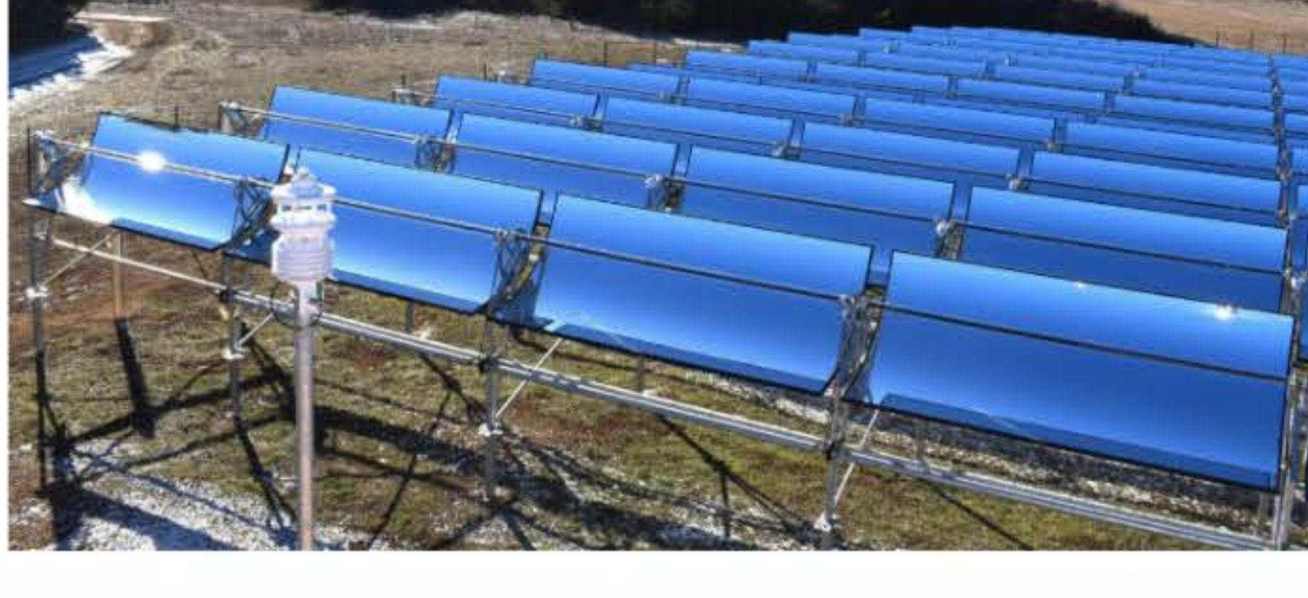
Les capteurs solaires installés dans la base militaire de Saint Christol d'Abdon
